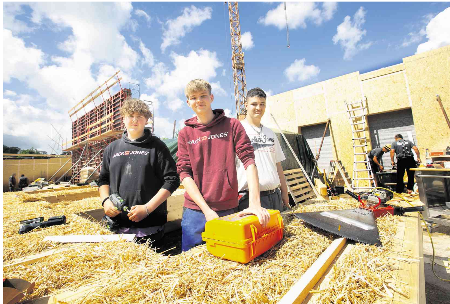
Die Drei von der Baustelle: Lukas, Anton und Dustin (von links) helfen mit bei den Dämmarbeiten.
