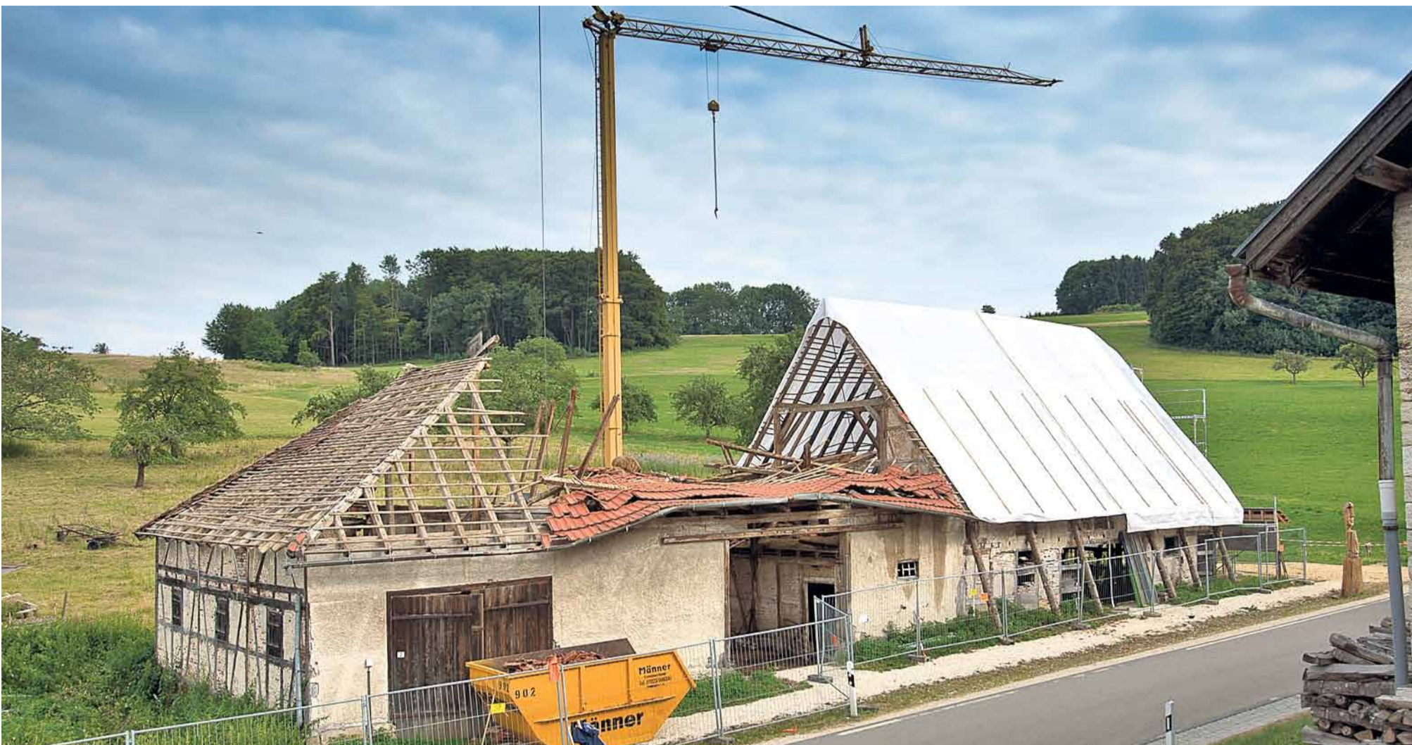
Auf dem oberen Bild ist der Schafstall als Bauprojekt zu sehen, bei dem es noch um eine grundlegende Sanierung ging. Stattdessen plant die Ziegelhütte jetzt einen Neubau am Randecker Maar. Das Bild unten zeigt die Überreste des alten Schafstalls und eines Fahrzeugs nach der Brandnacht im November.
