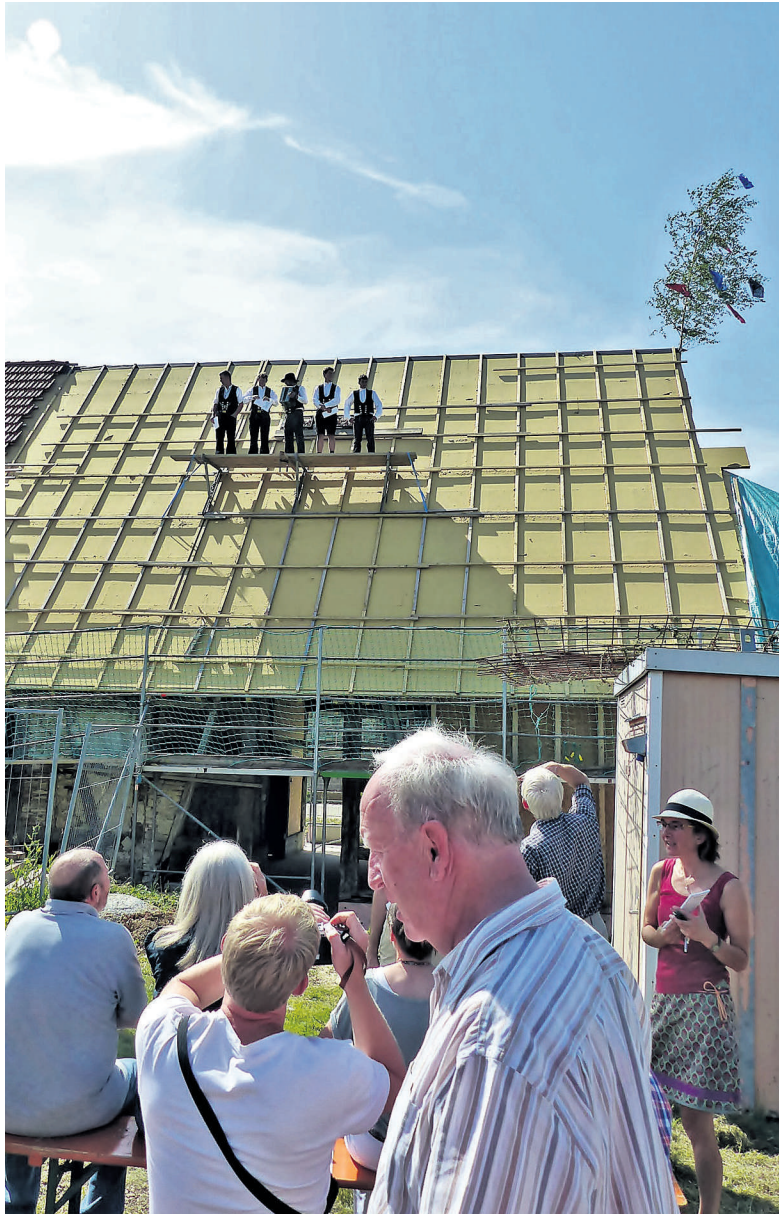
Das Richtfestbäumchen ist aufgerichtet und die Zimmerleute sprechen den Richtspruch auf dem Schafstallgebäude. Foto: Sabine Ackermann
